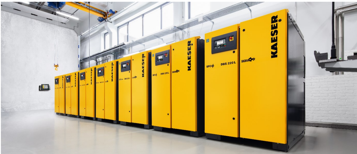
Foto equipos Kaeser
